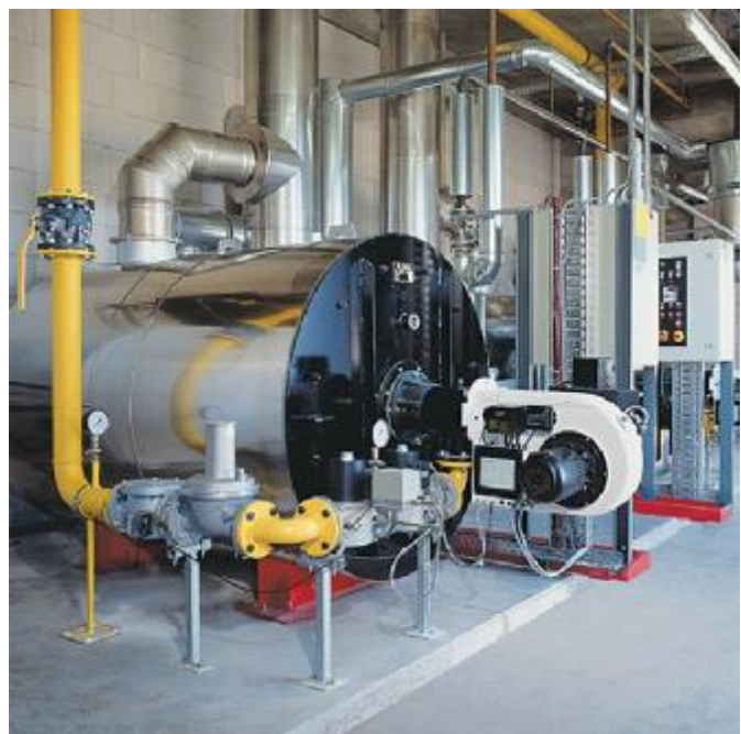
Die Heizkesselzentrale: Herzstück der gesamten Backofen-Anlage.
